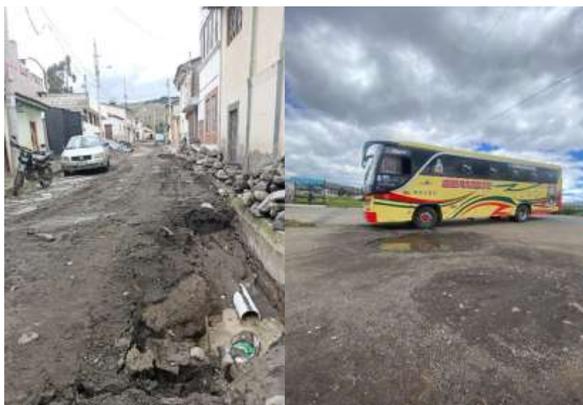
Ilustración 6: Deterioro de la calzada en las calles de la parroquia Palmira
